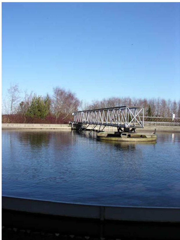
Klaringstank på Langå Rensningsanlæg.
