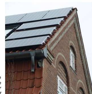
Solcellerne er usammenhængende og spredte og afstandene til tagets afgrænsninger er ikke tilgodeset. Udragning af blanke bæreskinner forstyrre desuden helhedsindtrykket
