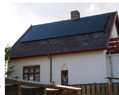
Solcellepanelet er placeret for højt på tagfladen. Synlig og umotiveret tilslutning af anlægget skæmmer helhedsindtrykket
